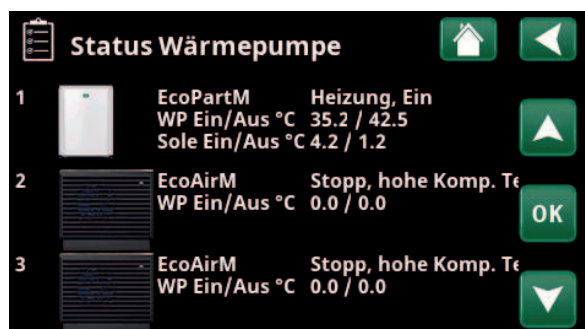
Das Menü zeigt den Status und die Betriebstemperaturen festgelegter Wärmepumpen.
